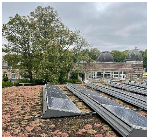
Toiture végétalisée combinée à du photovoltaïque, IRM Uccle (source : Marion Julien)
