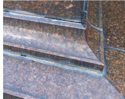
Het grafteken is op een slechte manier opnieuw gevoegd. De voegen zijn beschadigd en soms zelfs verdwenen.
