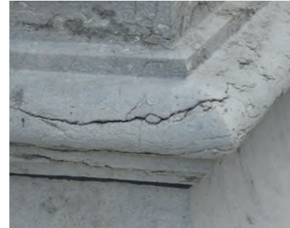
Het grafteken werd gereinigd met een te agressieve techniek, waardoor de steen is gebarsten.
